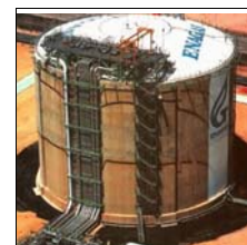
LNG Storage Tank
